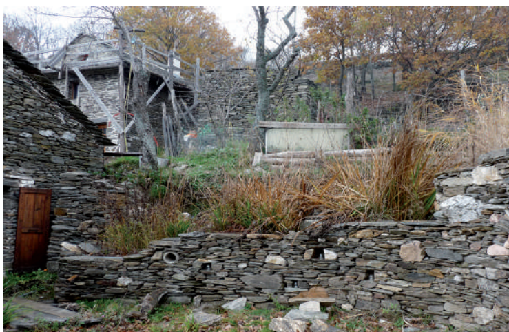
Assainissement par filtres plantés, écogite de Vieljeuves (48)
